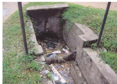
(d) Stagnant water and debris on main drains
